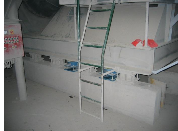
Fan (Cement Mill)
